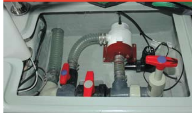
• le système de remplissage des ballasts sous la table
